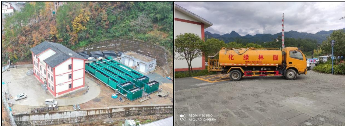
图 5.3-3 桥亭镇安置点污水处理及回用
