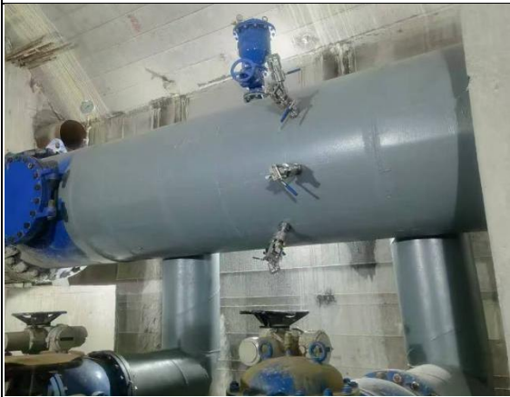
生态放水管（室内）
