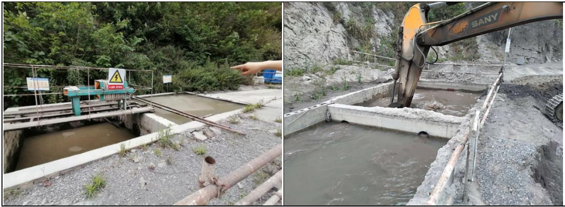
图 5.1-6 拌合系统废水处理设施
