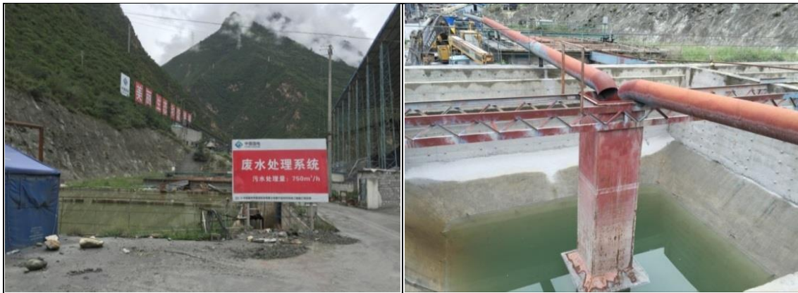
图 5.1-5 砂石加工系统废水处理设施
