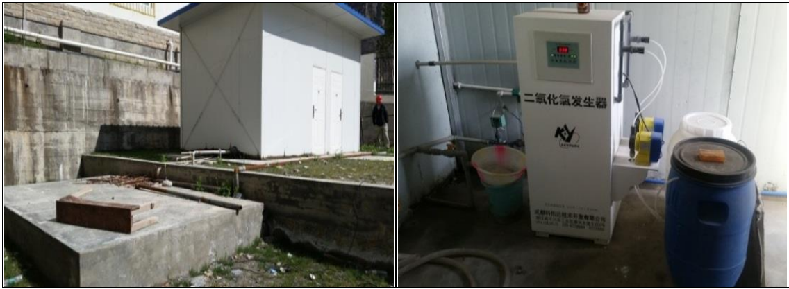
图 5.1-8 生活污水处理设施
