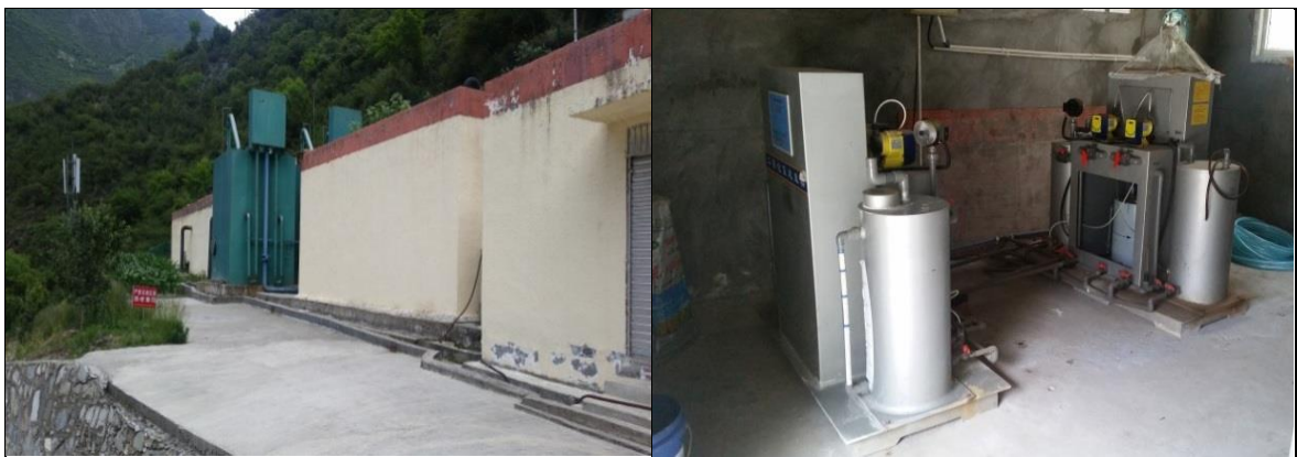
图 5.3-4 净水厂水处理设施
